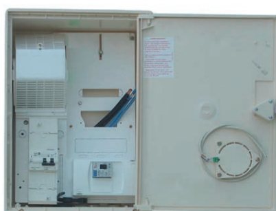
COFFRET DE CHANTIER
