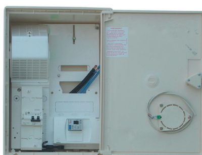
COFFRET DE CHANTIER
